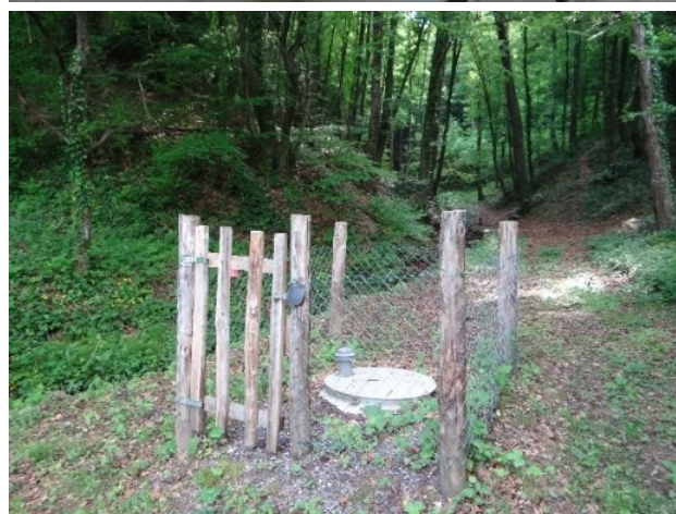
Slika 12. Automatski klorinator postavljen u vodospremi (Planina Donja), i postavljen direktno na vodovodnoj cijevi koja ide od izvora (Planina Gornja)
