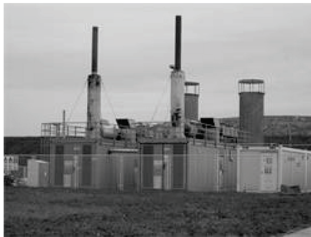
Slika 7. Sustav otplinjavanja i plinsko postrojenje (MTEO JAKUŠEVAC), http://www.zgos.hr/ , 29.01.2014.
